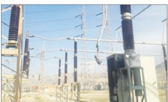
اهواز - رحمان محمدی: مدیر امور بهره برداری ناحیه شرق شرکت برق منطقه ای خوزستان را ارائه توضیحاتی در خصوص حادثه رخ داده در پست برق امیدیه ۱، گفت: در کمتر از دو ساعت قاعده معیوب جدا و خاموشی که در بخش هایی از شهرستان امیدیه رخ داده بود، برطرف شد.
